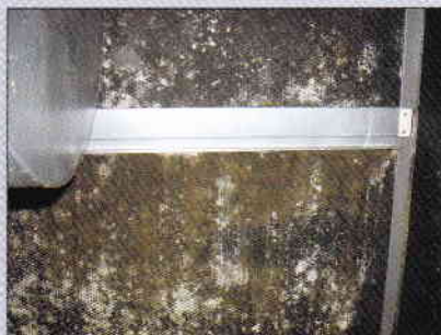
空調機内部のカビ
